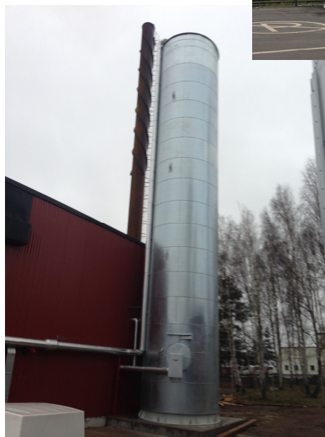
Vertikal tank på 100 m 3 diameter 2900 mm. Tanken er forsynet med 200 mm isolering og dækplade.
