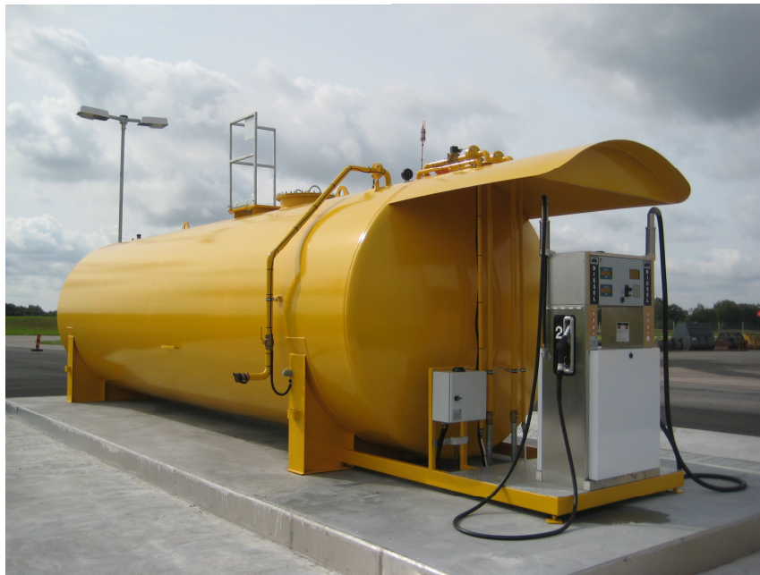
Tankanlæg til diesel med en 40 m 3 dobbeltvægget tank.
